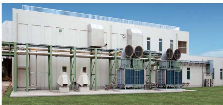
中部下水処理場の消化ガス発電設備
