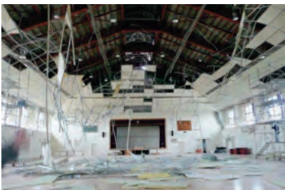
他都市の天井脱落の様子
