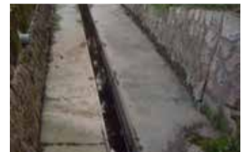
流れの悪い側溝
