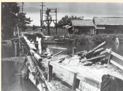
壊れた瀧口橋
