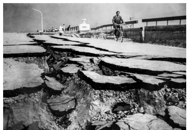
昭和大橋地割れする
