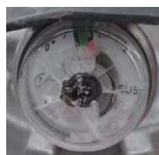
× 指示圧力計の損傷
