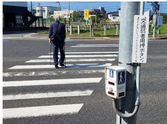
写真 2-8 青延長用押ボタン付き信号機
