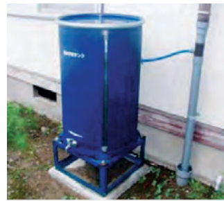
雨水貯留タンク
