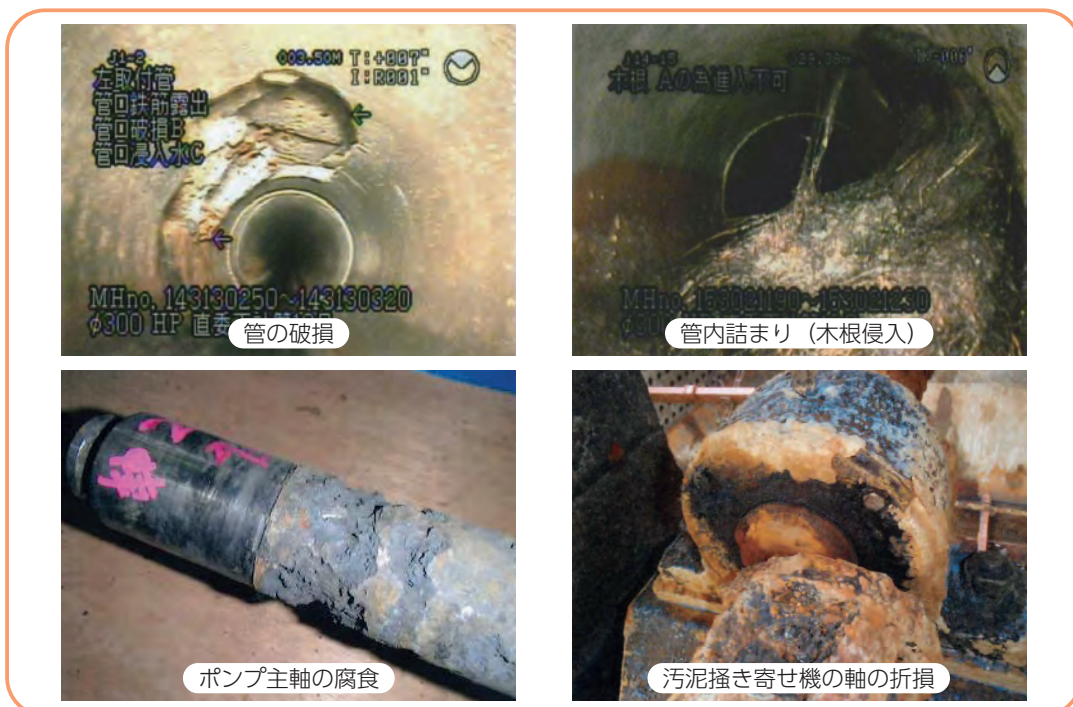
【下水道施設の不具合の状況】
