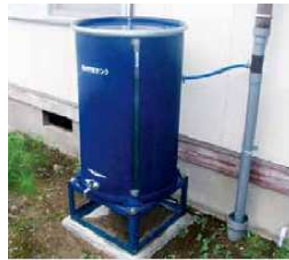
雨水貯留タンク
