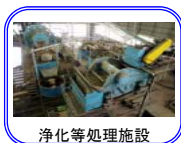
浄化等処理施設
