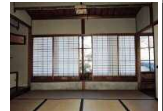
・居室部 2 階全体の不陸による建具の開閉の困難
