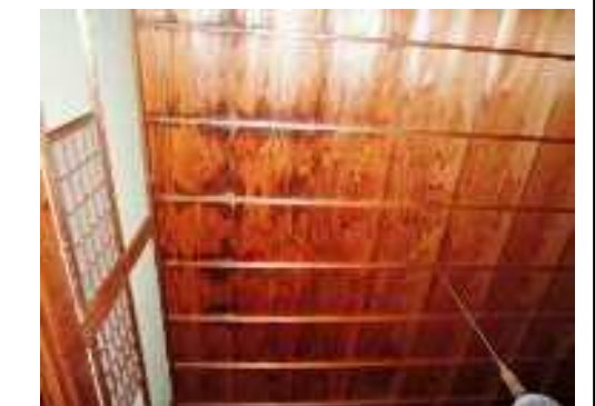
・居室部 2 階座敷天井の雨染み、畳にも雨染みあり
