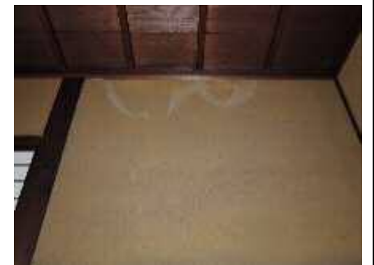
・廊下境小壁に雨水による水染みが見られる。軽微な雨漏れと考えられるが、点検、修理が必要（表座敷家老の間）
