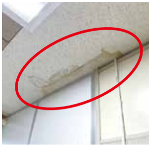
▼1階天井雨漏り
