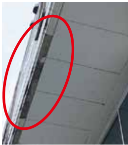
▼おもいやり駐車場側外壁コンクリート一部剥離
