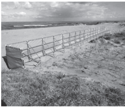
松浜海岸に設置された飛砂防止ネット
